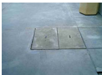
Arqueta en solera
